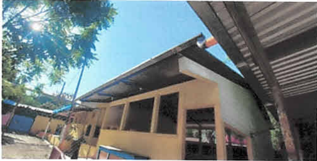
Foto 1: CANALES PARA LAS CAIDAS DE AGUA
