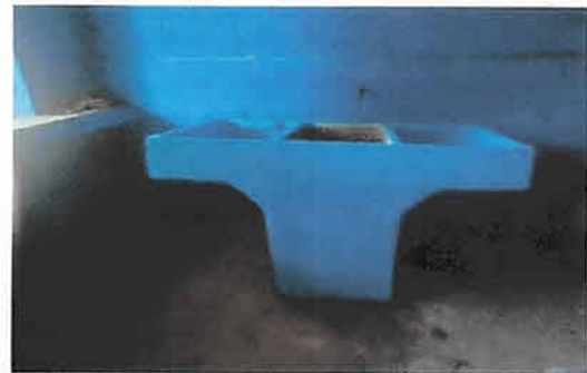
Foto 6: PILA DE 2 LAVAMANOS
